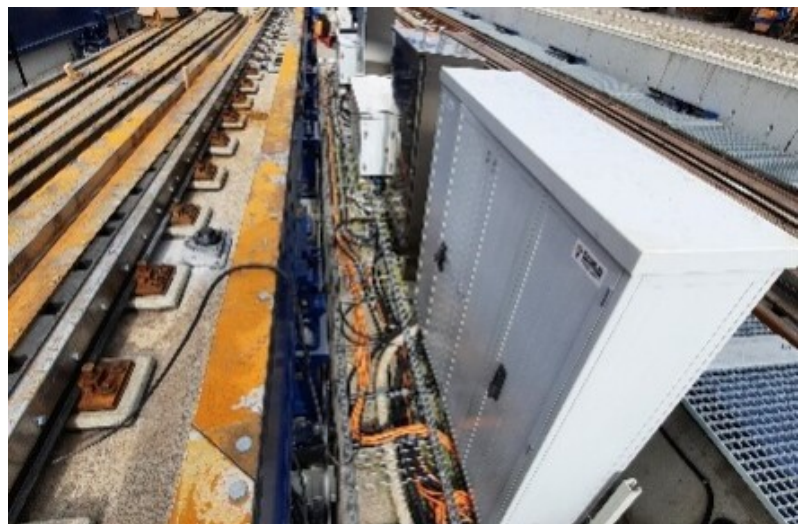
Installationsbereich zwischen den zwei Anlagen für die Schalttafeln der Energieversorgung, Heizung, Hydraulik und der Anlagensteuerung.
