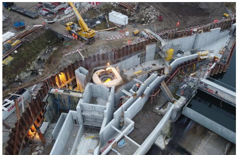
Fouille de la centrale de dotation avec dispositif de montée et de descente des poissons, travaux de bétonnage et levage du cône
