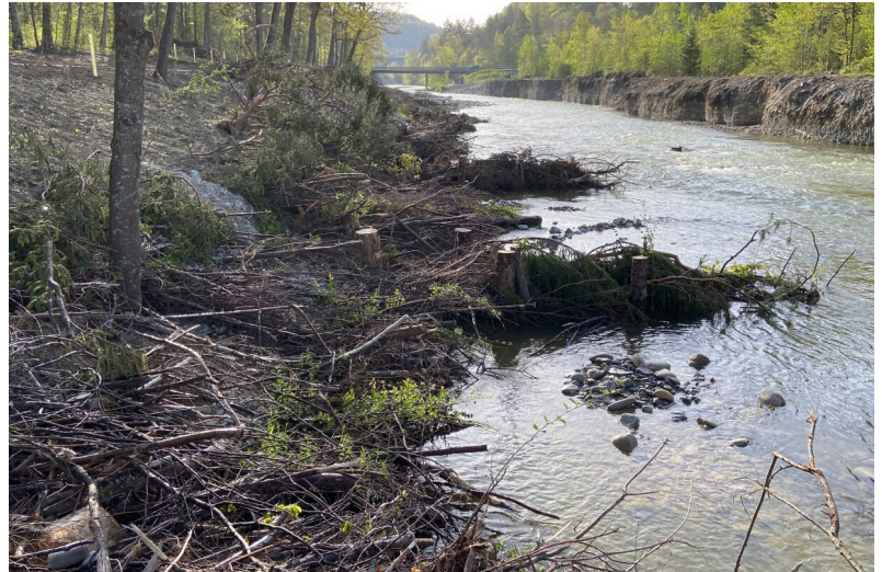
Protection mécanique biogène des rives et arbres en épis sur la rive droite, élargissement sur la rive gauche ; vue contre le sens d'écoulement
