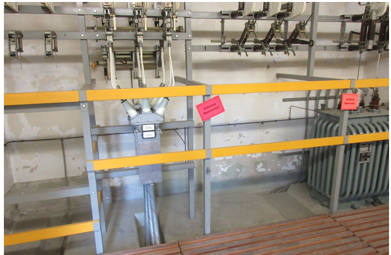
Trafostation Brunnadernrain vor der Sanierung
