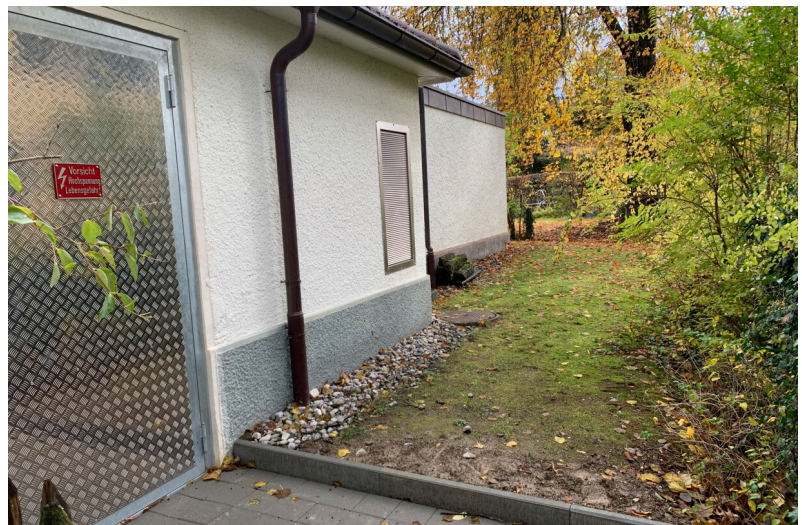
Poste de transformation Brunnadernrain après la rénovation
