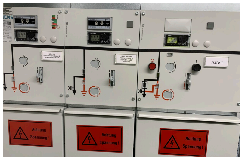
Poste de transformation Brunnadernrain après la rénovation
