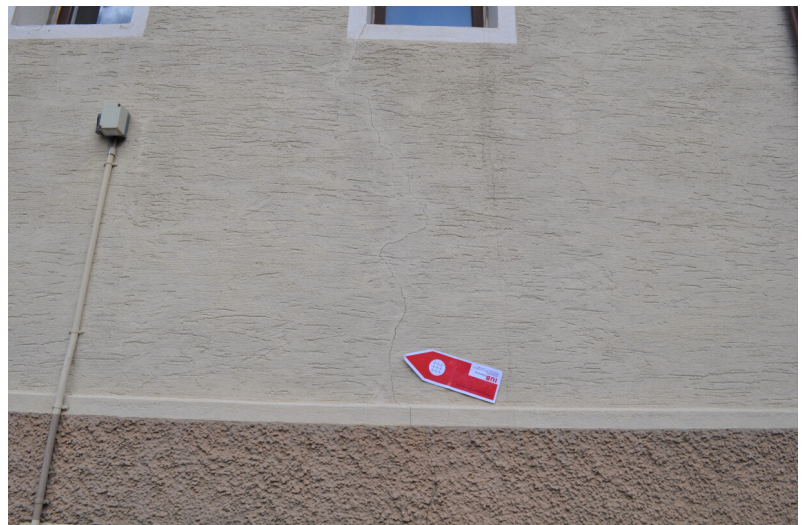
Riss in Fassade, mit Markierpfeil
