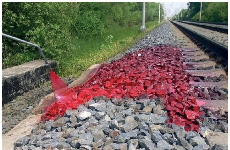
La stabilizzazione superficiale della massicciata ferroviaria può essere resa visibile tramite colorazione
