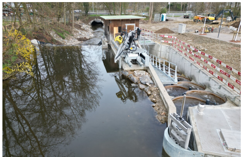
KW Sursee mit neuem Horizontalleitrechen-Bypass-System und Mäanderfischpass
