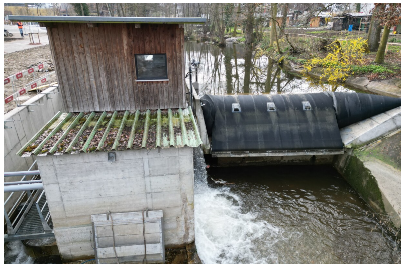
Blick vom Unterwasser auf das neue Schlauchwehr mit Konturmembran
