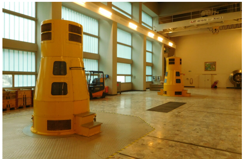
Salle des machines de la centrale d'Ova Spin
