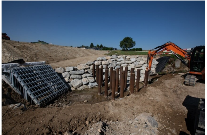
Einlaufbereich mit Grob- und Feinrechen
