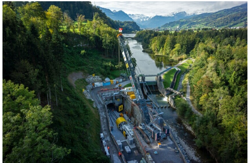
Montage du tunnelier devant le futur ouvrage de sortie devant le lac de Wichel endigué
