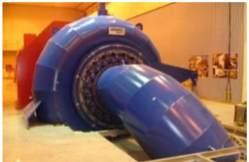
Nouveau groupe 3 dans centrale souterraine Unteraa
