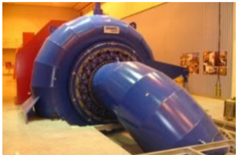
Nouveau groupe 3 dans centrale souterraine Unteraa
