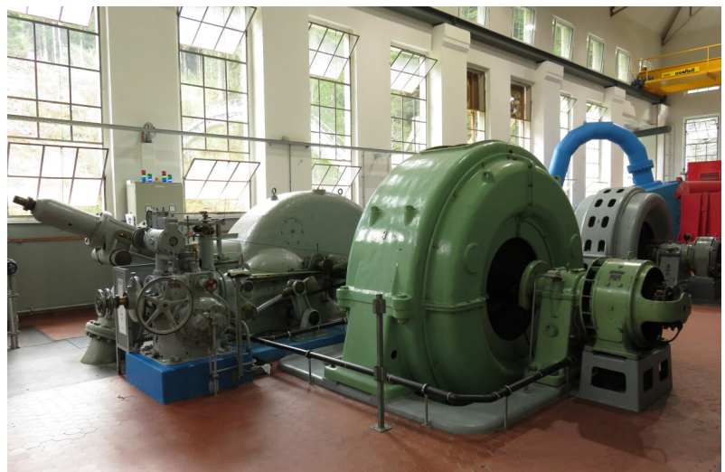
Zentrale Lügen vor der Erneuerung der Maschinengruppen
