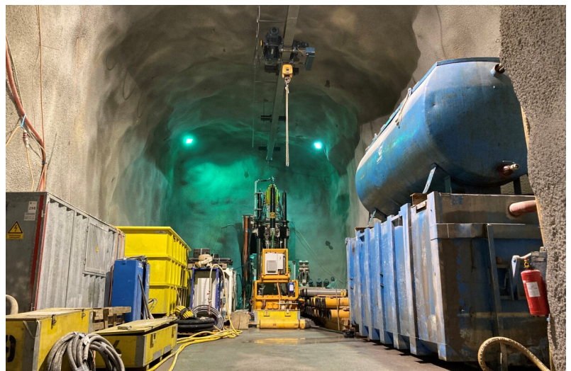
Caverna della testa del pozzo con installazioni Raise-Boring
