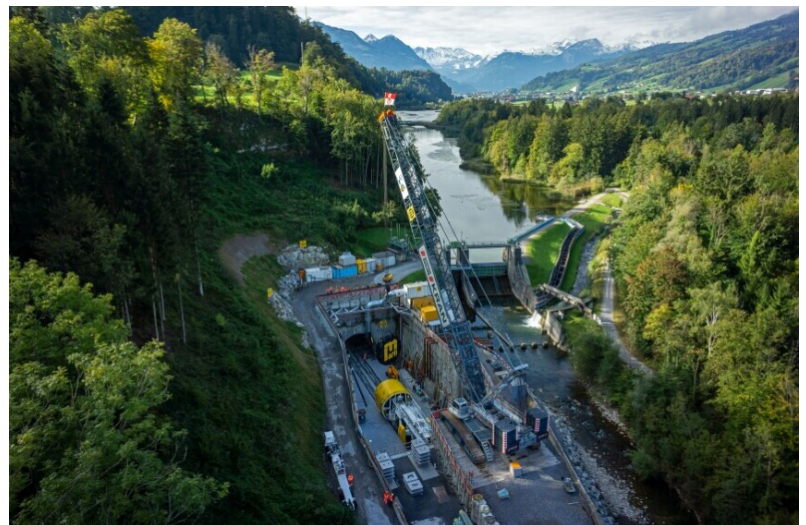
Montaggio della fresa per tunnel davanti alla futura struttura di scarico di fronte al lago di Wichel arginato
