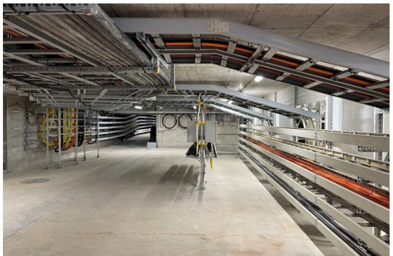
Cantina dei cavi
