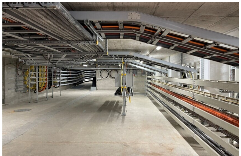
Cave à câbles
