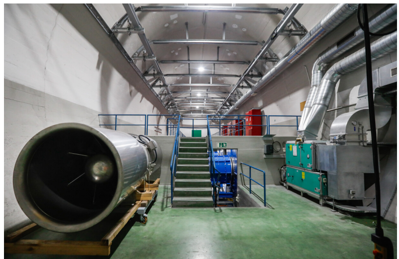
Centrale de ventilation du tunnel de San Bernardino
