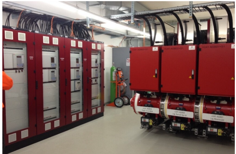
Locaux moyenne tension du tunnel de San Bernardino
