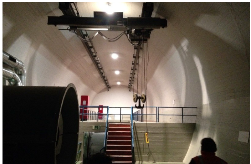
Lüftungszentrale San Bernardino Tunnel
