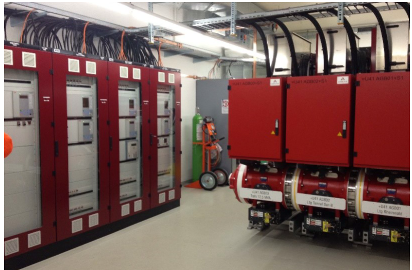
Mittelspannungsräume San Bernardino Tunnel
