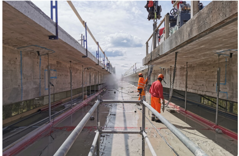
Démolition en TPC avant un élargissement nécessaire à la gestion du trafic
