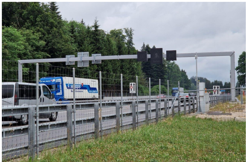
BSA auf der offenen Strecke der A1
