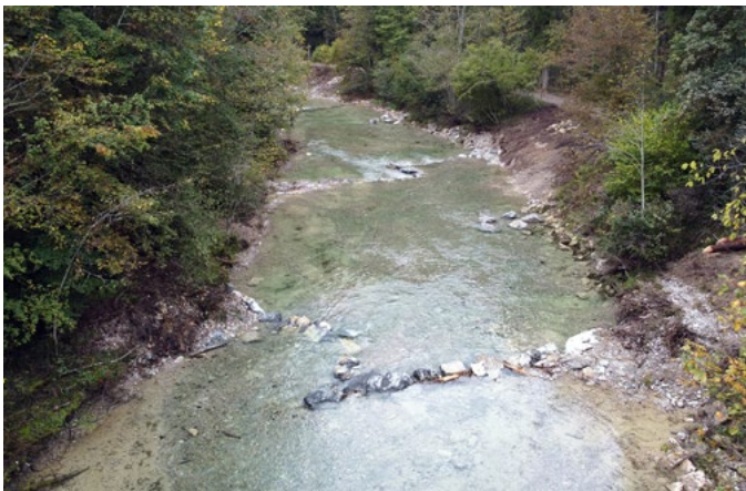
Bild 5: Blick in Fließrichtung kurz nach der Bauabnahme der Blocksteinriegel im Herbst 2021, Q = 0,69 \text{ m}^3/\text{s} (IUB Engineering AG).
