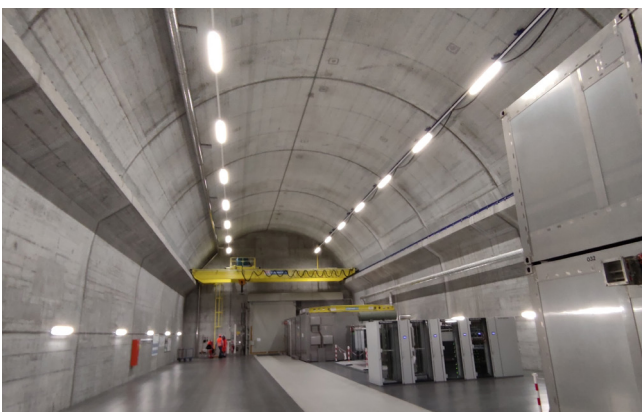
Lötschberg Basistunnel: Betriebszentrale Mitholz West (Kavernenzentrale)
