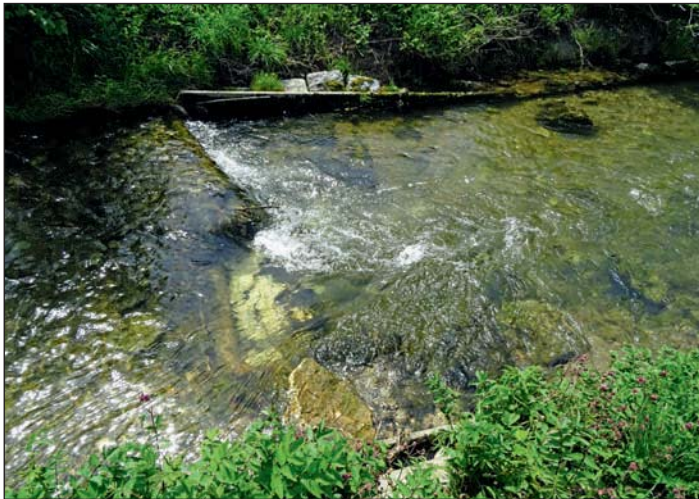
Abbildung 3: Beschädigte Sohlenschwelle (Q = 450 l/s) Figure 3: Seuil enterré endommagé (Q = 450 l/s)
